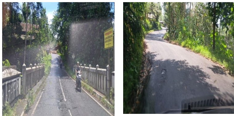
Gambar 2. Retak kulit buaya dan lubang
